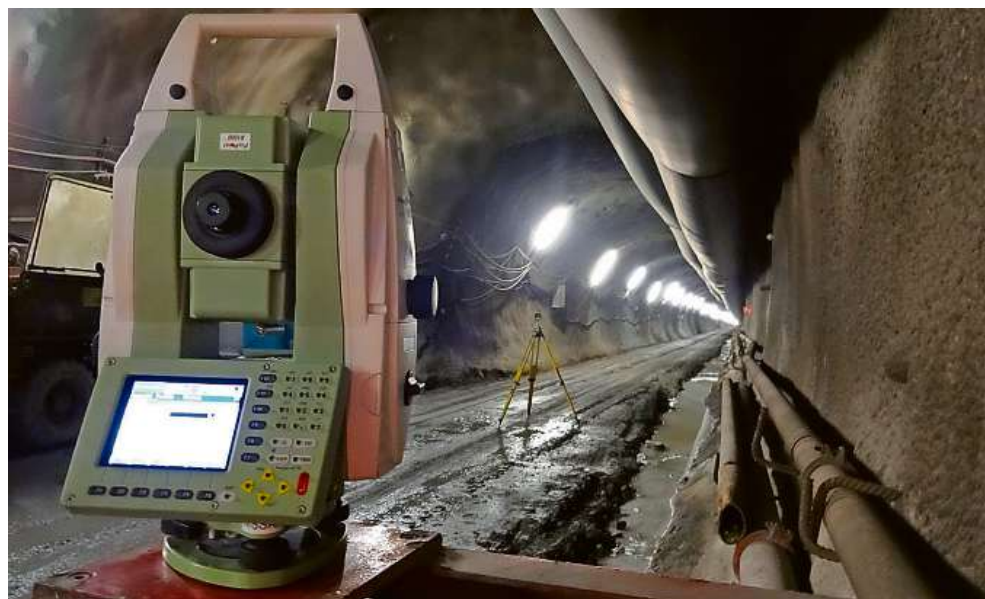
Auch die Vermessung des Brennerbasistunnels gehört zu den Aufgaben der Grünenfelder und Partner AG.
